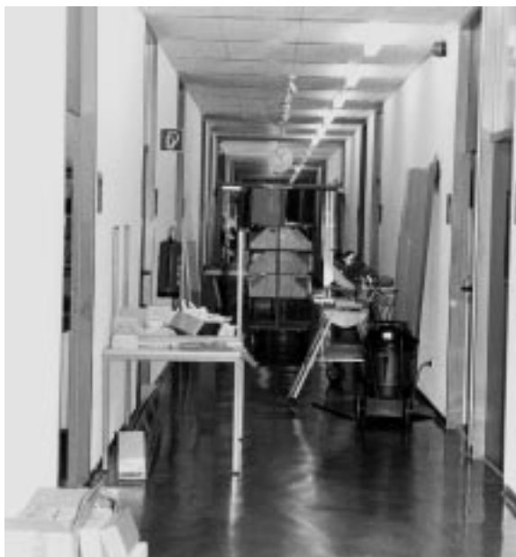
Großeinsatz (Juli und August) auf B 2: Elektro- und Datenleitungen in den Büroräumen werden modernisiert.
